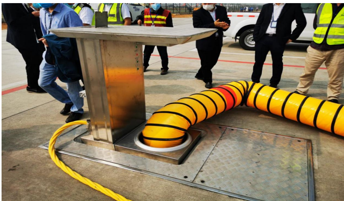
图6 双流机场远机位岸电设施升降井
