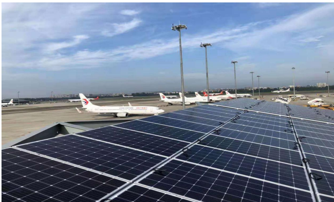
图5 双流机场南机坪光伏车棚
