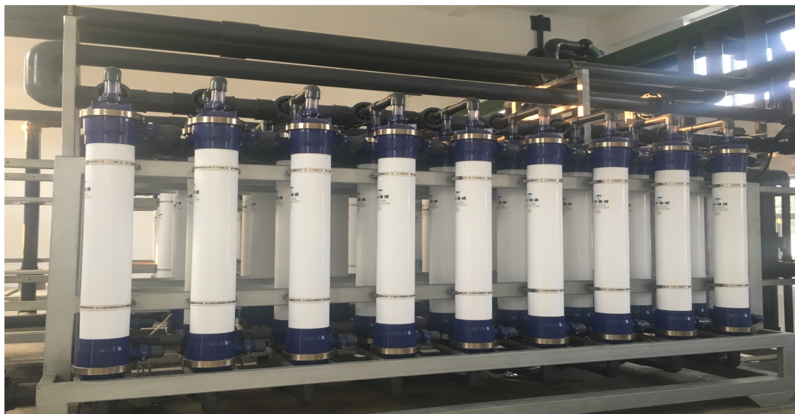
图 7 双流机场再生水回用厂超滤间
