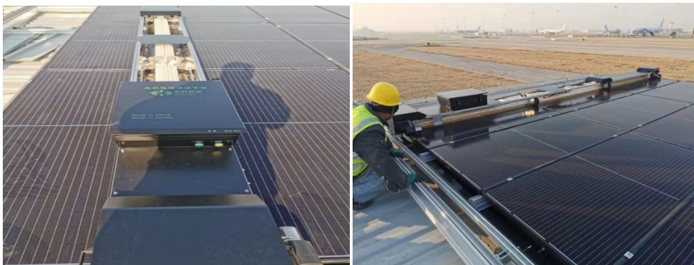
图 34 太阳能光伏板智能清扫机器人
