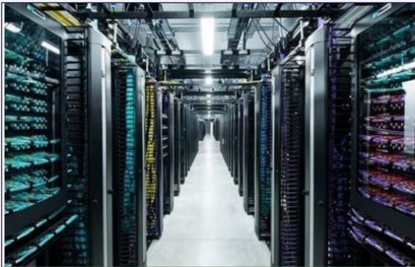
数据机房外观
